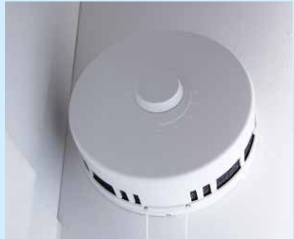
Raitisilmaventtiili voi sijaita esimerkiksi ikkunan vieressä. Raitisilmaventtiilien pöly pitää poistaa joko imurin pehmeällä suulakkeella tai kuivalla harjalla.
